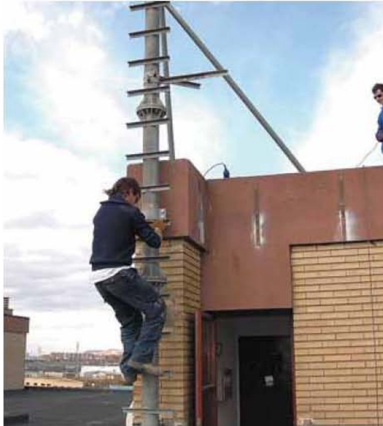
En plus des antennes relais, il a été retiré un poste de transformation de 12 mètres carrés
