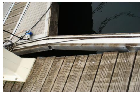
Ponton Port Epervière Valence Arrachement et déformation longeron métallique
