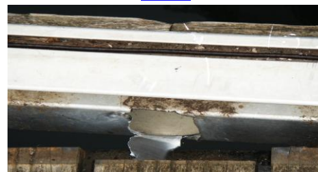
Ponton Port Epervière Valence Détail arrachement longeron métallique
